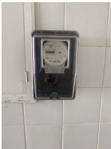
Figura 8. Medidor de energia
