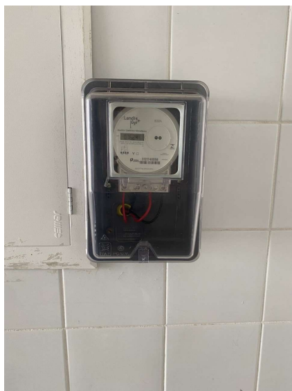
Figura 8. Medidor de energia
