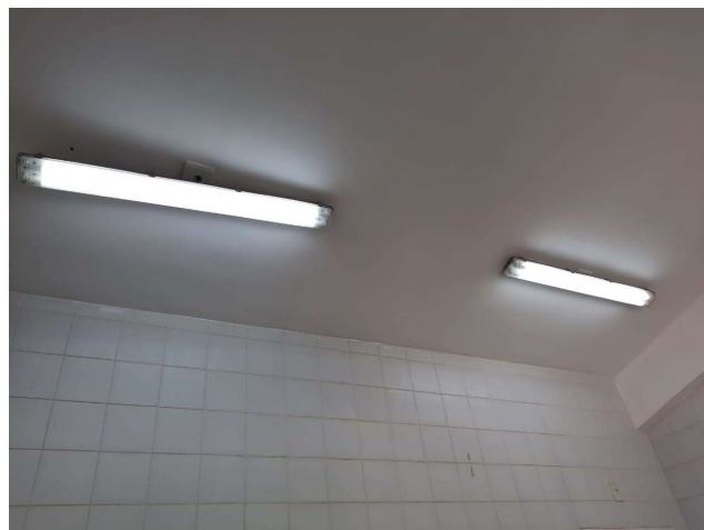
Figura 7. Luminárias da parte interna da cantina
